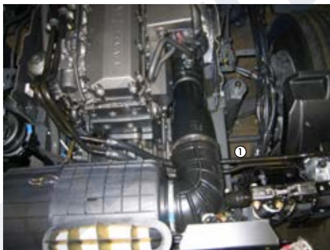
① Wasserrohre vom Heizgerät zum Wärmetauscher Water pipes from the heater to the heat exchanger
